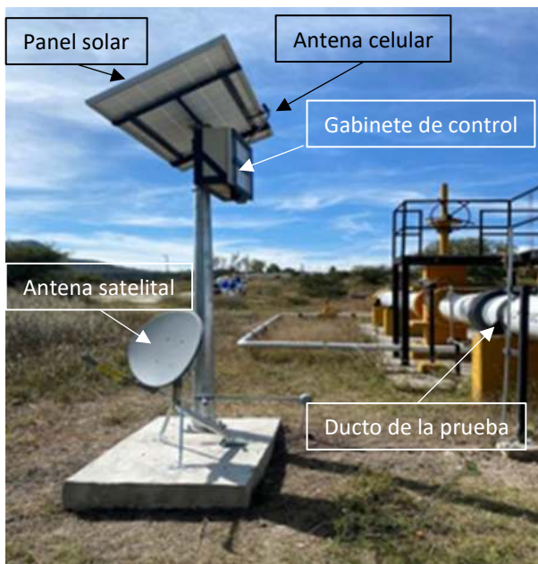
Fig. 7. Instalación en campo de una terminal remota.
