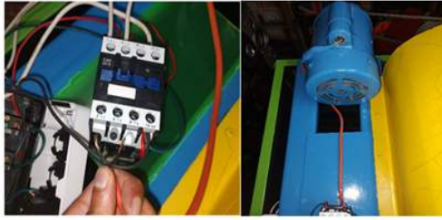
Fig. 9. Conexiones eléctricas. Fuente: elaboración propia.
